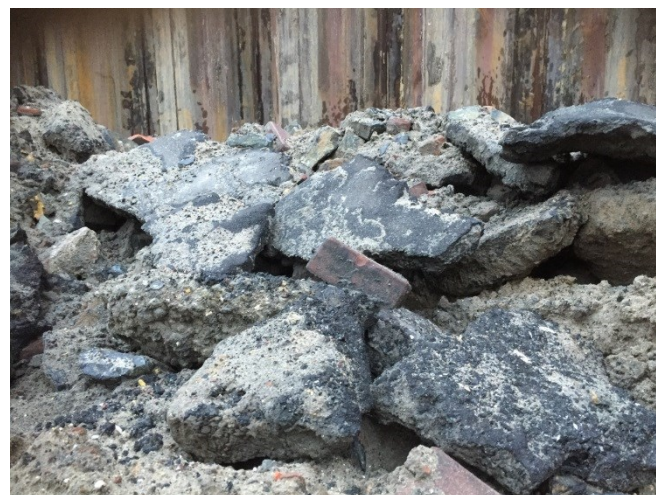
Afbeelding 1: in de bodem zit veel puin. Daardoor gaan de damwanden moeilijk de grond in. IXAS neemt maatregelen.
