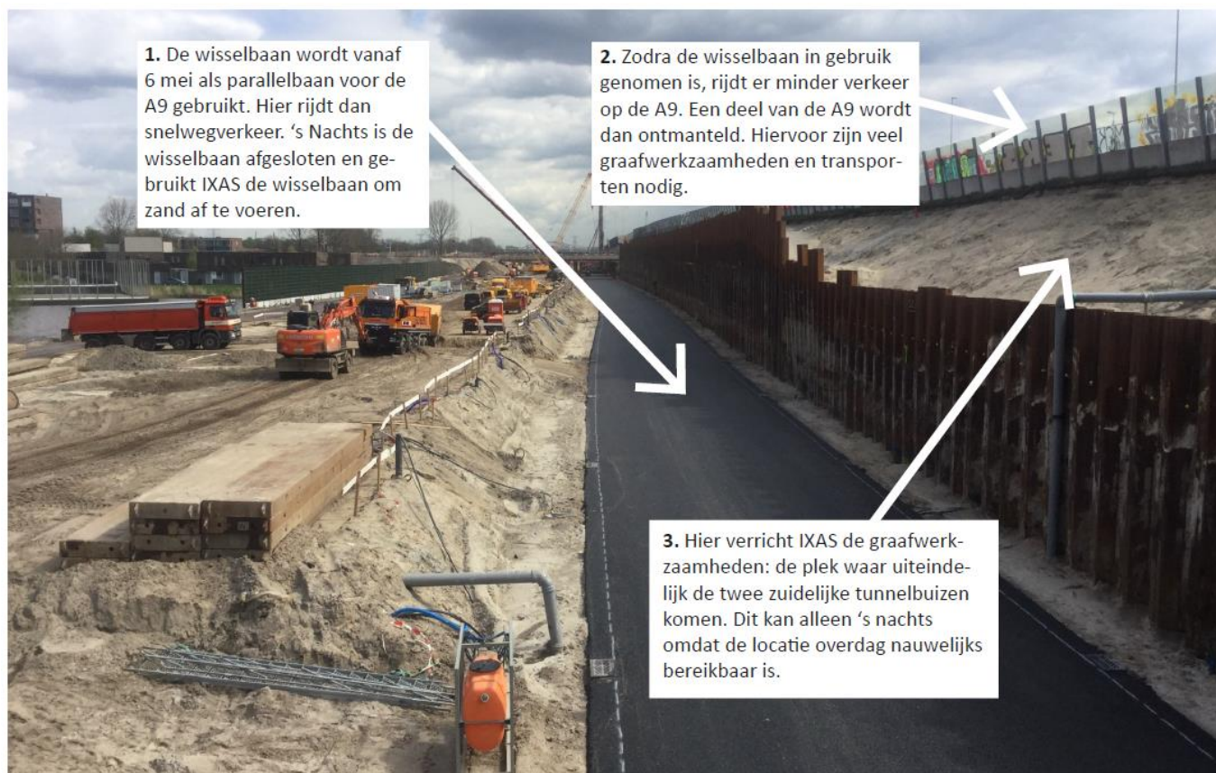
Afbeelding: de locatie van de graafwerkzaamheden. Het afvoeren van het zand gaat over de wisselbaan.
