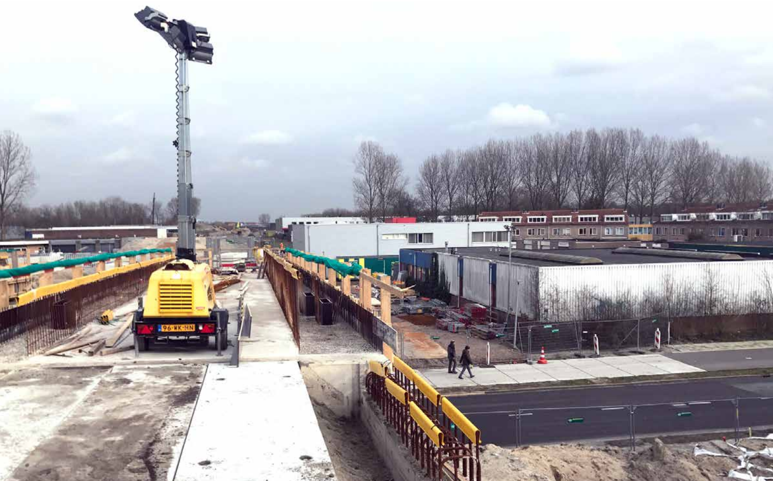
De aanleg van het nieuwe viaduct de Gildemark in de Steigerdreef. Het viaduct gaat over de busbaan heen.
